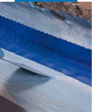
A Mapeband helyére ragasztása Mapelastic® AquaDefense-vel fal és padló vízszintes és függőleges felületei között
