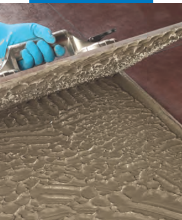
A burkolóanyag hátoldali fedettségének ellenőrzése
